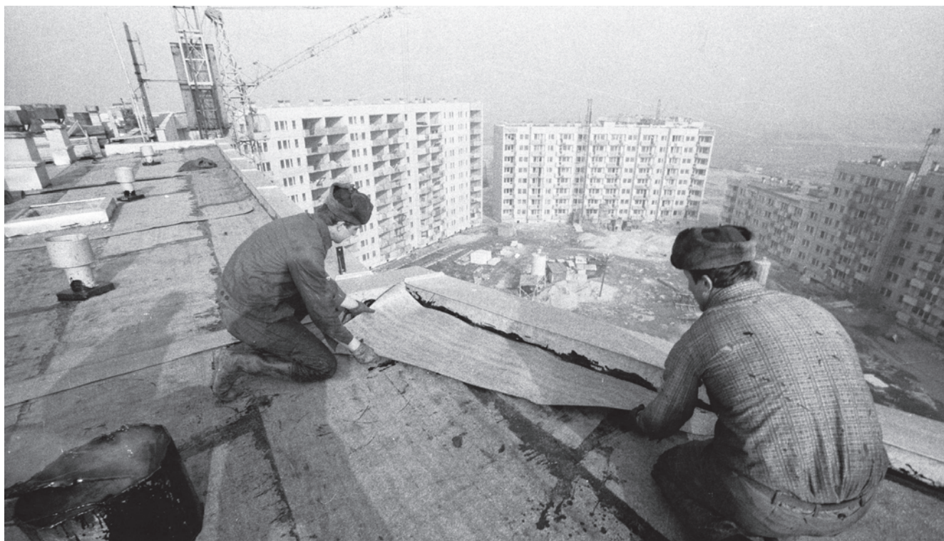
75. Budowa osiedla mieszkaniowego Bemowo, którego wykonawcą był Kombinat Budownictwa Mieszkaniowego. Prace wykończeniowe na dachu wieżowca, Warszawa, 15 lutego 1982 r. Fot. Wojciech Frelek. Zbiory PAP.
