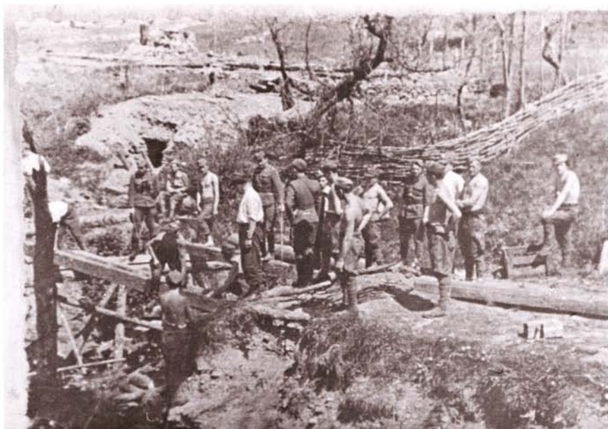
Saperzy batalionu KBW „Poznań” podczas budowy prowizorycznej przeprawy w miejscu zniszczonego przez UPA mostu na drodze ze Smereku do Wetliny
