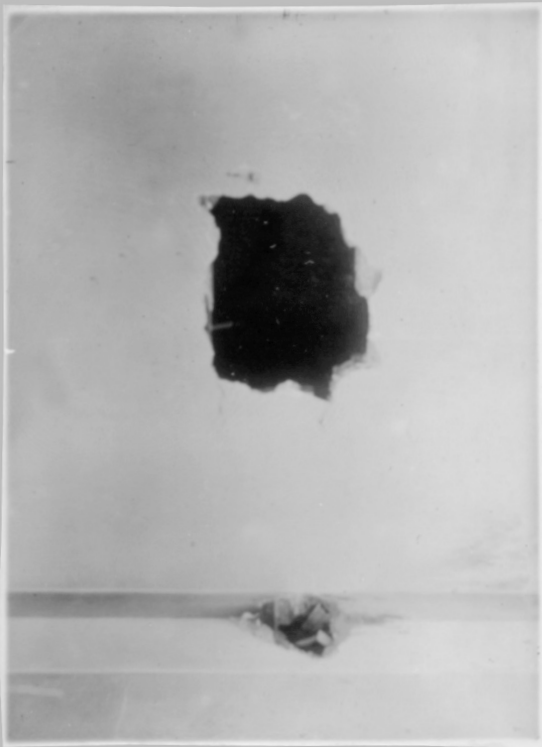
127 Wyłom w ścianie.
