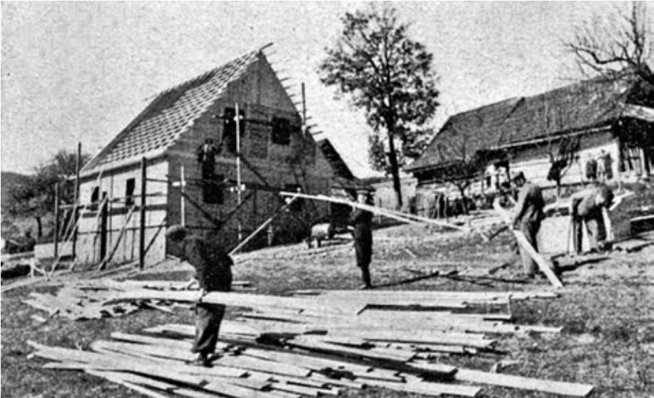
Budowa drewnianego domu dla rodziny robotnika leśnego na Żywiecczyźnie. W 1941 r. planowano, że tylko w najbliższych miesiącach na terenie powiatu powstanie 70 domów tego typu. Wartość jednego z nich wynosiła 12 tys. RM. Niestety, nie da się dziś stwierdzić, czy zamierzenia te zdołano zrealizować. Źródło: AP Kat
