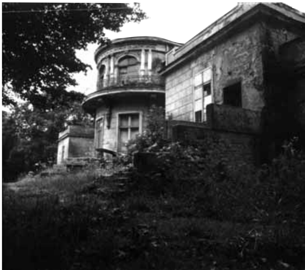
Zniszczony dwór w Bytyniu
