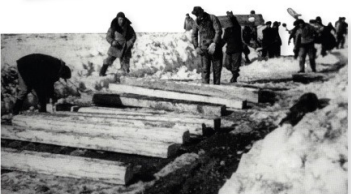
↳ Transpolerna Magistrala Kolejowa – od początku bezsensowna: już po kilku latach od rozpoczęcia budowy stała się niepotrzebna i zaczęła niszczeć, stając się Martwą Drogą
